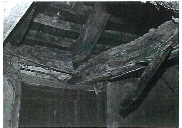
Foto 3: Zerstörter Deckenbereich unter undichter Dachhaut
